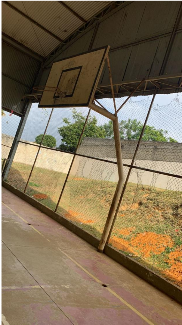
Equipamento de esportes desgastados.
