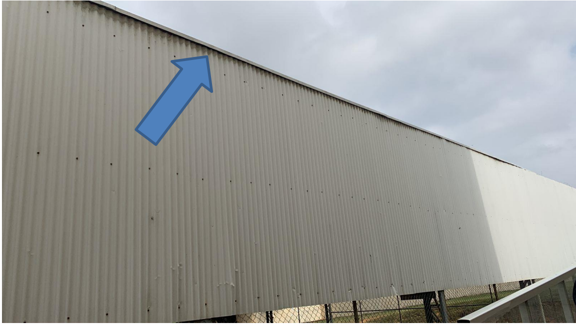
As calhas laterais apresentam uma deformação e oxidação.
