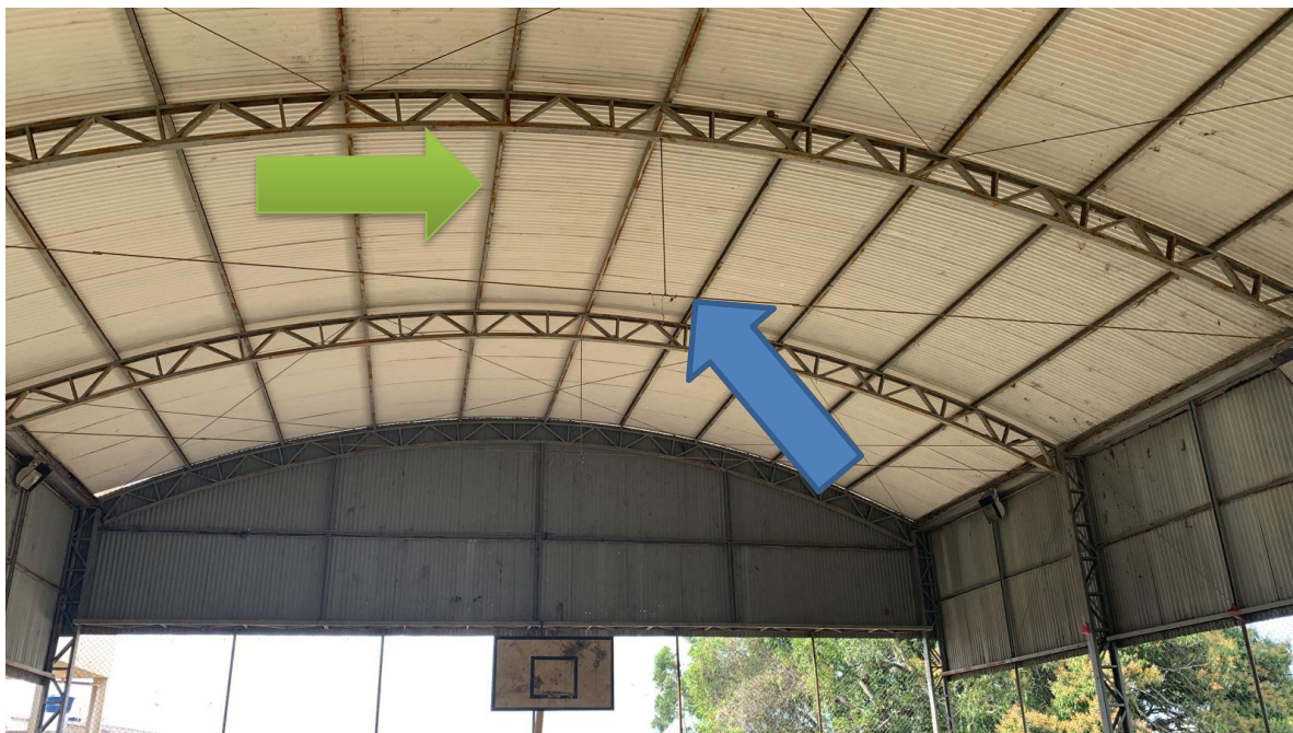
Tirante com estado avançado de oxidação
