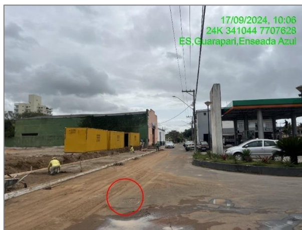
Figura 76: Alameda Boa Ventura com destaque para a tampa do poço de visita da rede de esgoto.
