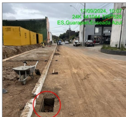
Figura 77: Dispositivo de drenagem na Alameda Boa Ventura.
